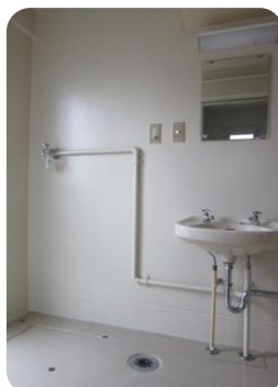
洗面器／洗濯機置場
