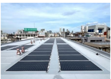
太陽光発電設備
