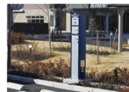
駐車場のEV用充電器
