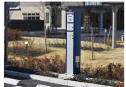
駐車場内のEV用充電器
