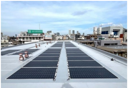
太陽光発電設備
