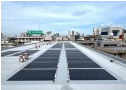
太陽光発電設備
