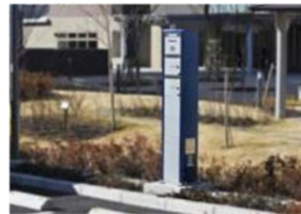
駐車場内のEV用充電器
