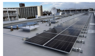
太陽光発電設備
