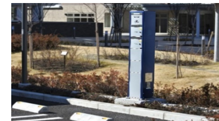
電気自動車充電設備
