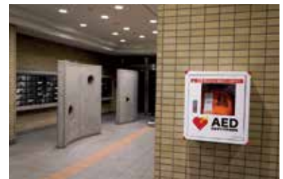
AEDは1階エントランスに設置
