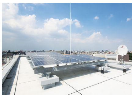
JKK住宅の太陽光パネル
