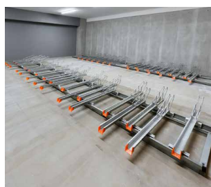
自転車置場 (屋内) (写真は1号棟)
