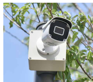
防犯カメラ 各棟のエントランス等の共用部に複数 の防犯カメラを設置しました。
