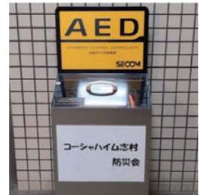
주택 입구에 설치된 AED
