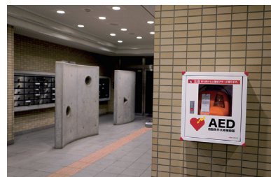
AED安装在1楼入口
